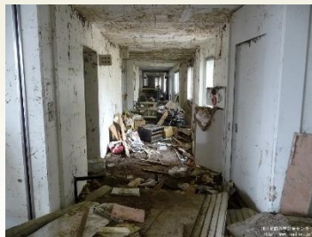
東松島市立野蒜小学校の被害の様子 出典：災害写真データベース
